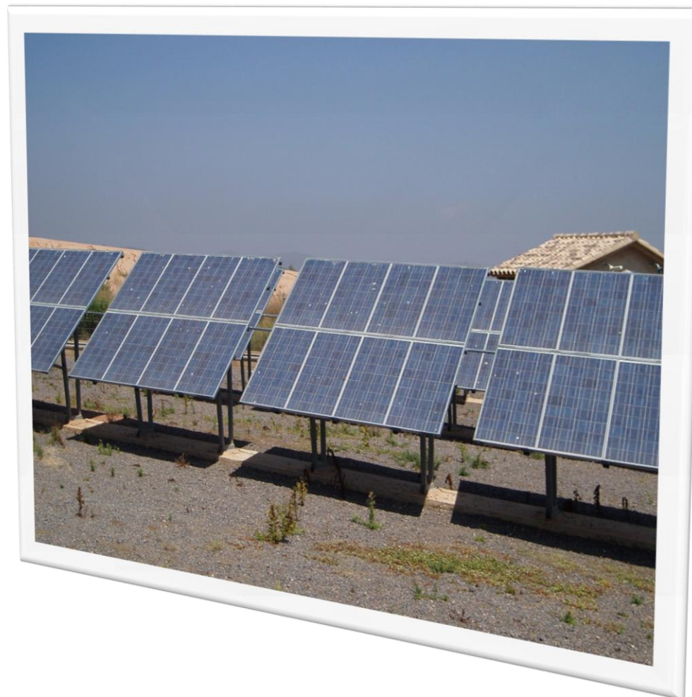
Planta solar fotovoltaica del CEACV
